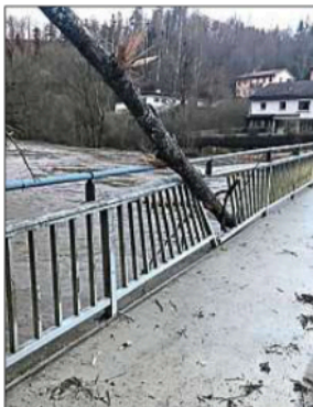
In die Brücke am Hochstein bohrte sich ein Baumstamm, der angetrieben wurde. – Foto: Landegl
