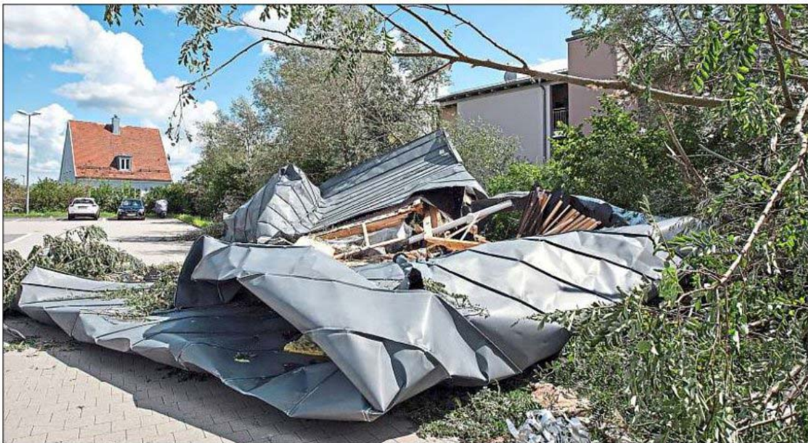
Wie eine Sardinenbüchse hat der Sturm dieses Dach in Untersölden in Grubweg aufgedreht. Eine Orkanböe reichte und 150 m 2 Dachfläche mitsamt dem Dachstuhl aus gefalztem Stahlblech landeten etwa 30 Meter weiter auf dem Parkplatz des Netto-Marktes. Die Mieter des fünf Jahre alten Hauses, ein Ehepaar im mittleren Alter, kamen mit dem Schrecken davon. – Foto: Eckelt
