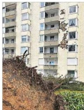
Fassade zerstört, Baum entwurzelte in der Vornholzstraße.
