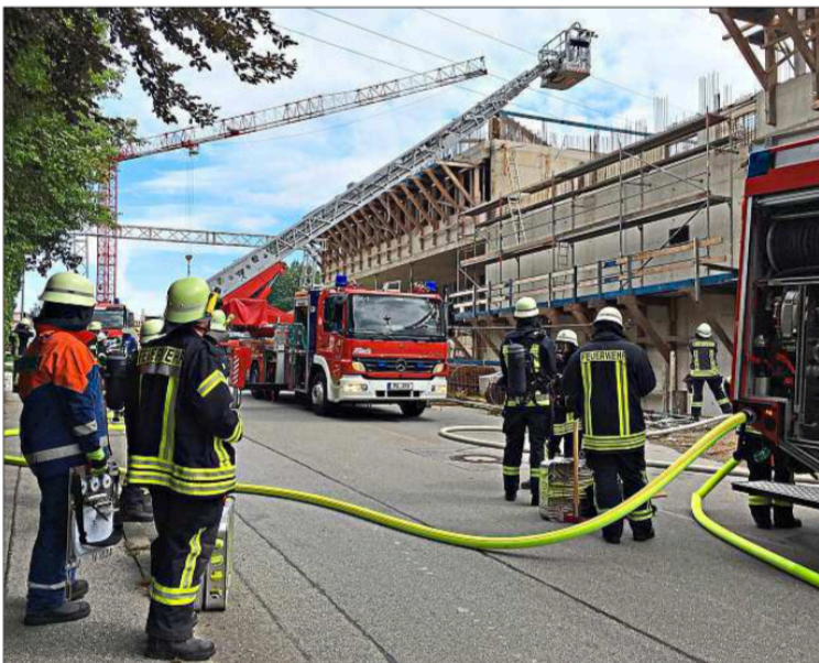
Mit der Wasserspritze an der Drehleiter begegnete man dem Feuer im mittleren Stockwerk des entstehenden Polizeigebäudes. Vor allem Atemschutzträger sorgten für ein schnelles Löschen der durch einen Bitumen-Kocher ausgelösten Flammen. Die Karlsbader Straße war für über eine Stunde total gesperrt. – Foto: Karl
